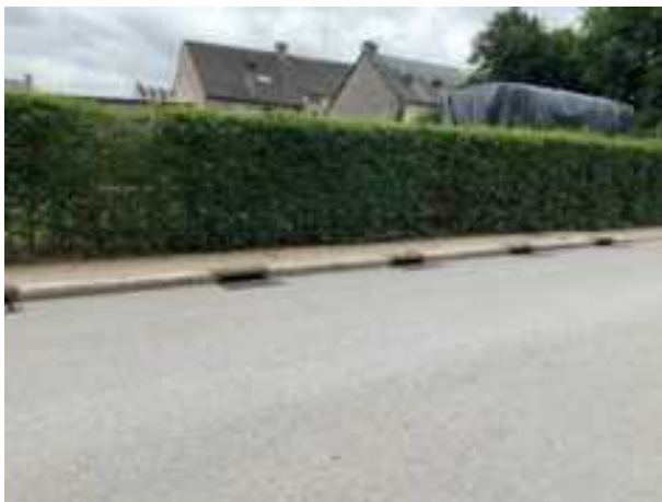
Abbildung 79: Mehrere Straßen- mit Seiteneinläufen auf kurzer Strecke auf RW-Achse
